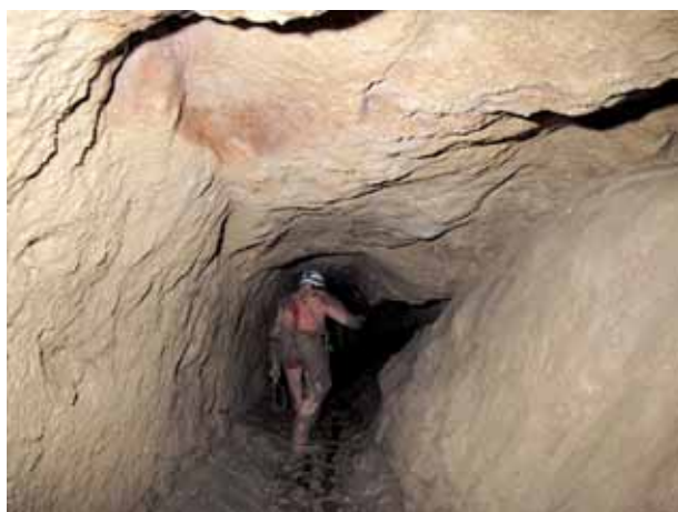
Fig. 8 - Tratto del cunicolo con deposito fangoso lungo le pareti
